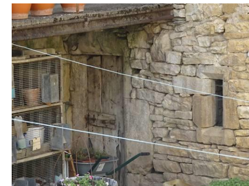
Chabrits, porte sous linteau ornée d'un arc en accolade et jour de cave en meurtrière de la seconde moitié du 15e siècle – début 16e siècle.
