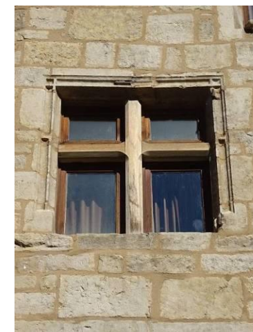
Rue de l'Ancienne Maison consulaire. Fenêtre à meneau à moulures croisées Seconde moitié 15e siècle – début 16e siècle. Le meneau et les croisillons disparus ont été remplacés par des éléments en bois.
