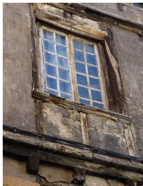
Rue de l'Epine. Menuiseries à petits carreaux adaptées à une fenêtre à meneau après disparition de la division initiale en bois.
